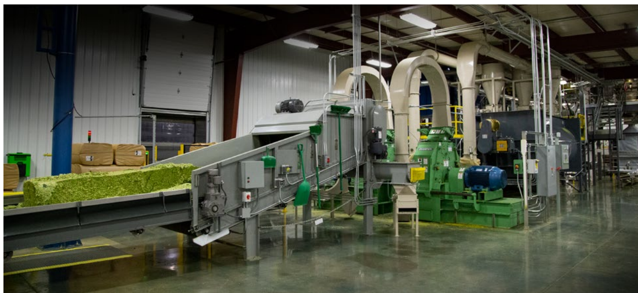
Usine de traitement du houblon de BSG – Wapato (Washington), États-Unis
